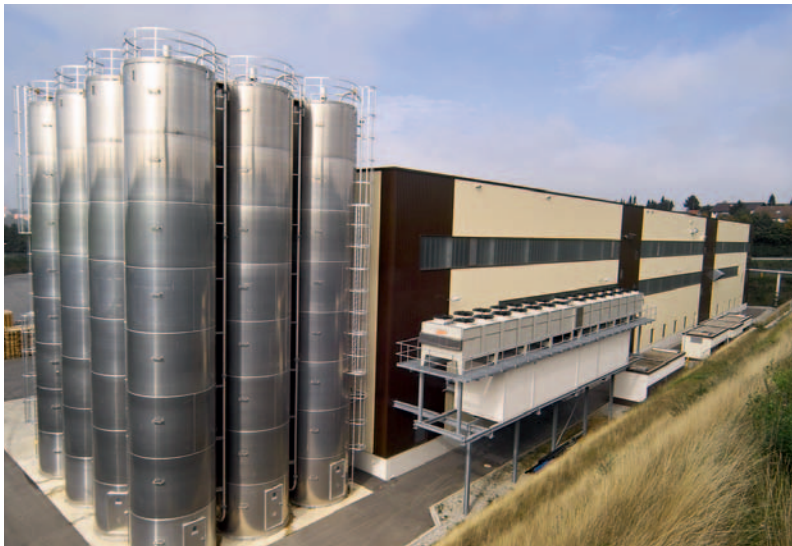
Abb. 1: Energie und Platz sparende Container-Kühlanlage mit Kaltwassersätzen SKL und energiesparender hermeticool-Technologie als maßgeschneiderte Lösung für den Kunden
