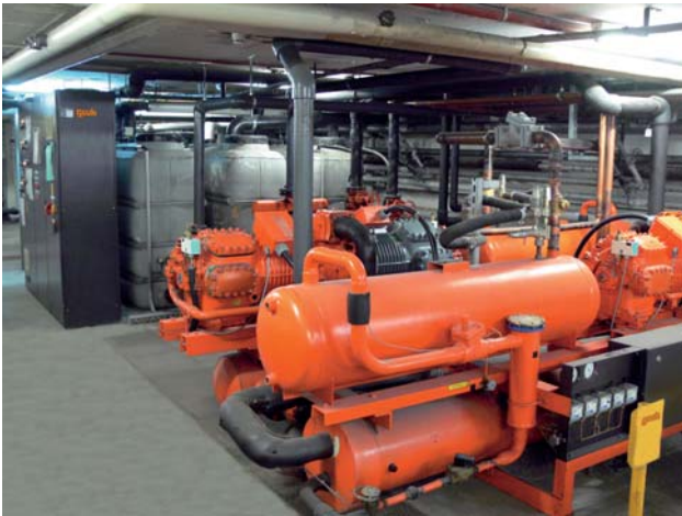
Zentrale Kühlanlage für das Becherwerk
